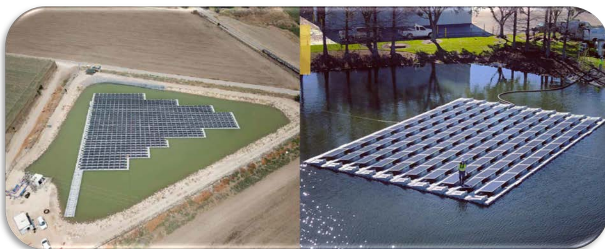
Figure 76 : Exemples de centrale photovoltaïques flottantes utilisant des structures Ciel&Terre (source : Ciel&Terre)
