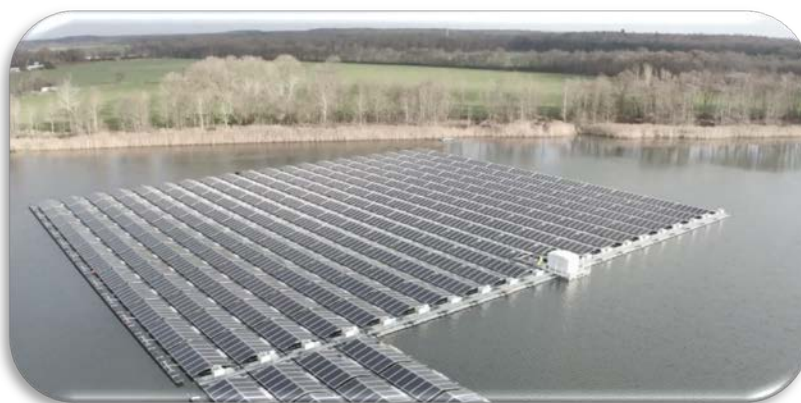
Figure 80 : Exemple de centrale photovoltaïques flottantes utilisant des structures Zimmermann (source : Zimmermann )
