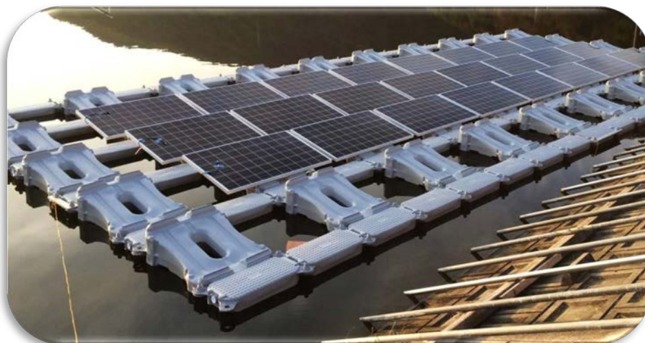
Figure 77 : Vue zoomée sur les structures photovoltaïques flottantes Ciel&Terre (source : Ciel&Terre)
