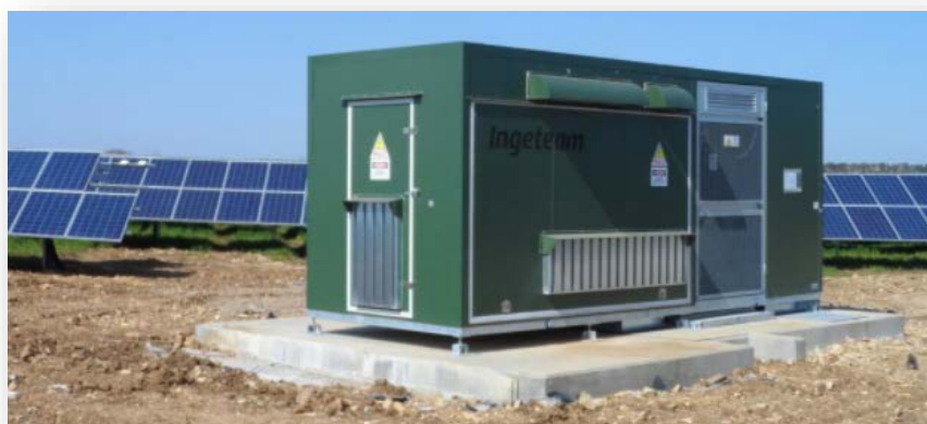
Figure 84 : Exemple d'un local technique transformateur type (source INGETEAM)
